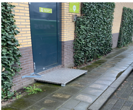
Obstakel op trottoir
